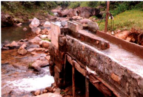
Photo 0 : Site d'installation et test des premiers modèles de pico turbines, depuis déjà plus de 4 ans
