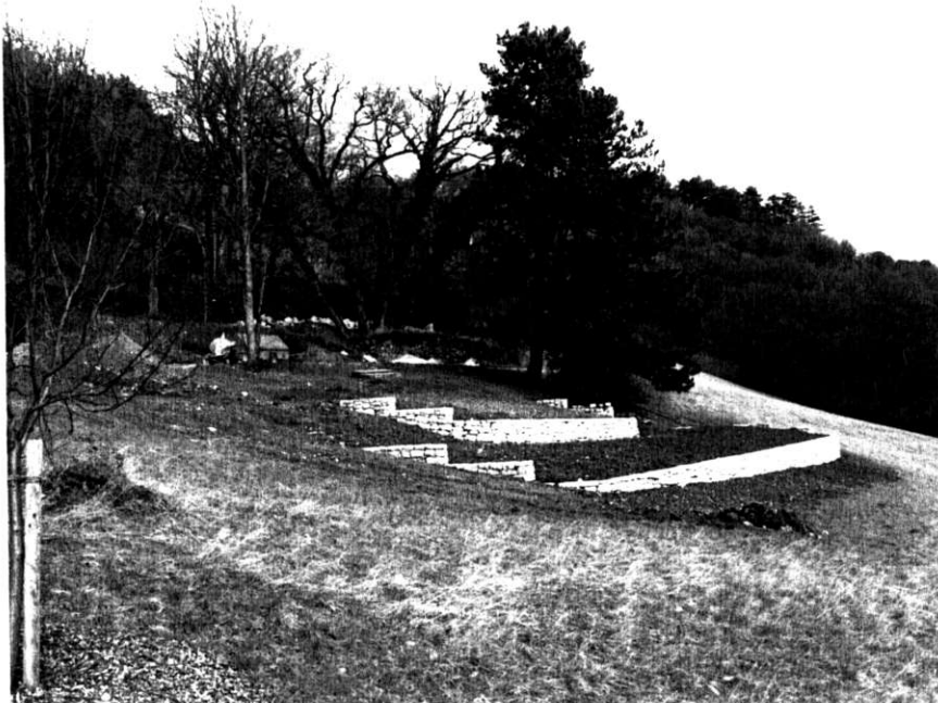
Les nouveaux murs secs, qui abriteront, entre autre, une collection de cépages neuchâtelois.
